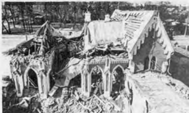
Зруйнована будівля Чернігівської ОБЮ
